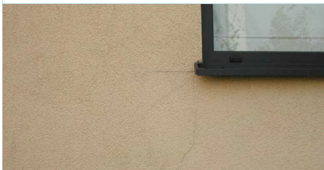
Fissuration de l'enduit à la jonction entre l'enduit et le seuil (l'évolution dépend des caractéristiques de l'enduit et de l'isolant).
