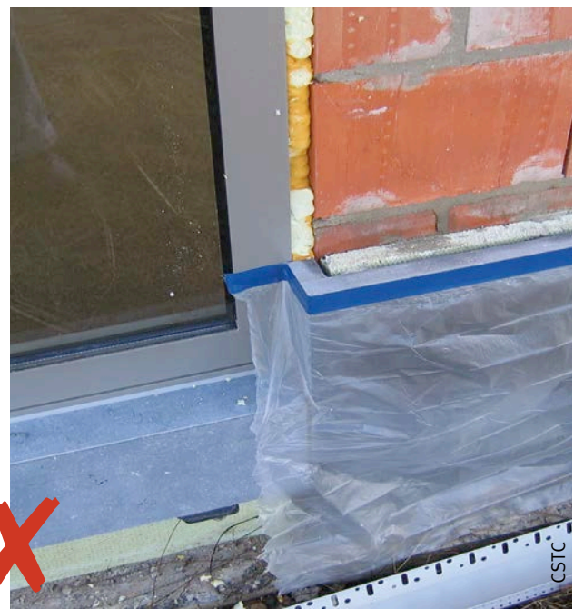
B. Non conforme à la PEB
