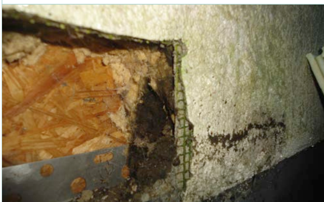
Pourrissement de l'isolant en fibre de bois observé lors du sondage au droit d'une fissure.
