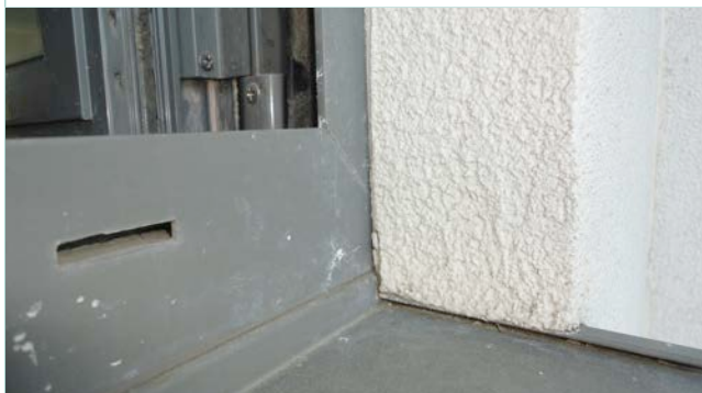
Infiltration d'eau à l'intérieur du bâtiment due à la jonction non étanche entre l'ETICS et la menuiserie.
