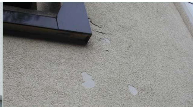
Défaillance du détail au droit du seuil menant à des infiltrations d'eau dans l'enduit, des boursouflures et des décollements.
