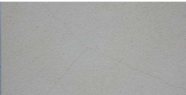
Fissuration de l'enduit minéral (retrait) en raison des conditions de prise et de durcissement ainsi que des caractéristiques de l'enduit.
