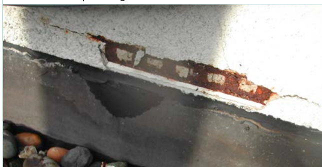
Corrosion d'un profilé de départ (inadapté, car dépourvu de larmier) en acier galvanisé.
