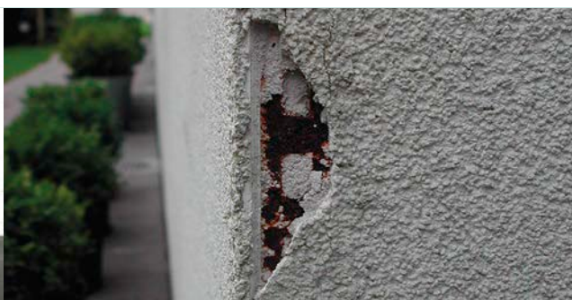
Corrosion d'un profilé d'angle en acier galvanisé.
