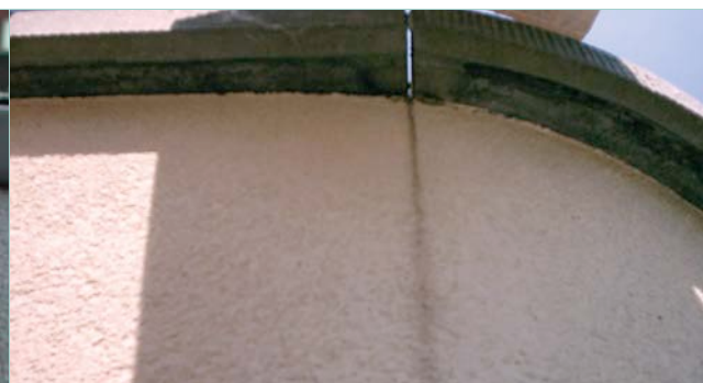
Écoulement et salissure en raison de la dégradation du mortier de joint.
