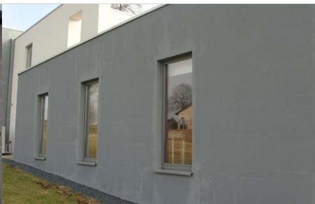
Processus d'humidification et de séchage de l'enduit différents à certains endroits résultant du non-respect des épaisseurs de contact minimales à la jonction entre l'ETICS et les menuiseries.
