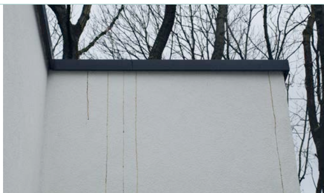
Écoulement d'eau chargée en tanin dû au choix inadapté du couvre-mur et à son humidification.
