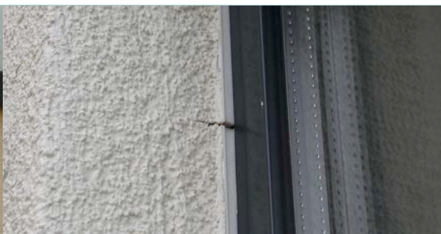
Fissuration de l'enduit à la jonction entre des profilés (l'évolution dépend des caractéristiques de l'enduit et de l'isolant).
