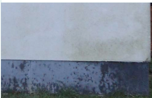
ETICS (isolant en fibre de bois) sur structure à ossature en bois avec panneaux supports d'ETICS. Façade très exposée aux intempéries et dépourvue de mesures de protection spécifiques (absence de débord de toiture, par exemple) et apparition de salissures.
