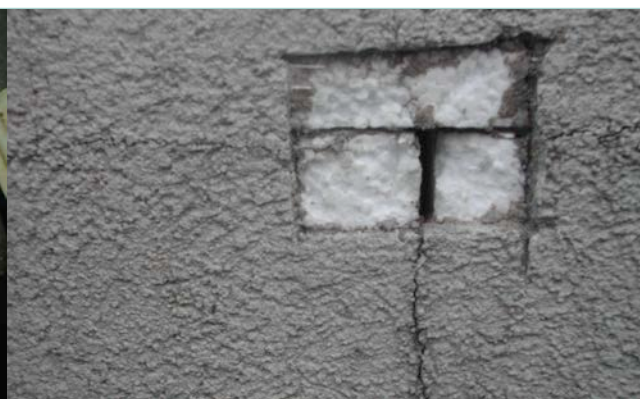
Panneaux d'isolation non jointifs donnant lieu à une fissuration de l'enduit.
