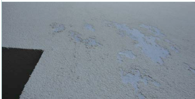
Durcissement insuffisant de l'enduit de finition organique et décollement.
