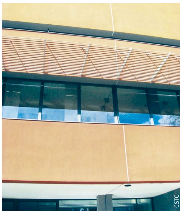
Fig. 87 Joints de mouvement à la surface d'un ETICS.
