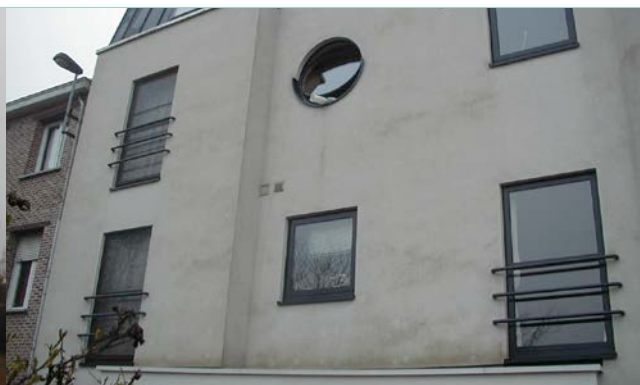
Vieillessement de l'enduit en zone urbaine.
