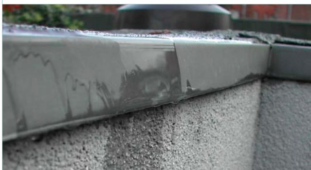
Larmier du couvre-mur inefficace.
